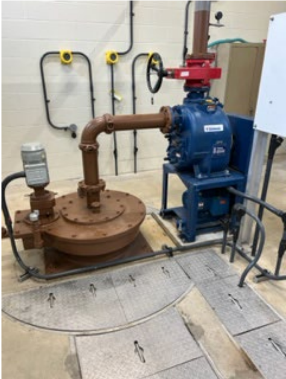
Vortex Grit Unit
